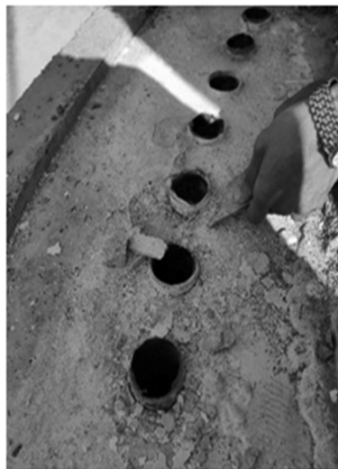
图3 转接环上锚板底部混凝土的表面缺陷
